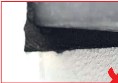
Voegdichtband 15/2-6 mm toegepast en te ver uitgezet = niet slagregendicht!
