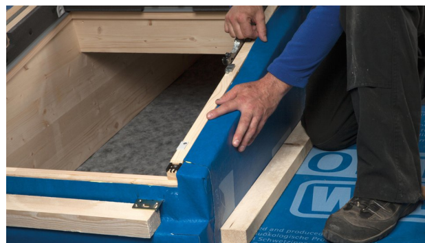
22. Verlijm SOLITEX WELDANO 3000 op de zijkant van het kozijn. Leg de folie met een uitzettingslus in de lijmlaag. Druk de lijm daarbij niet helemaal plat, zodat bewegingen kunnen worden opgevangen.
