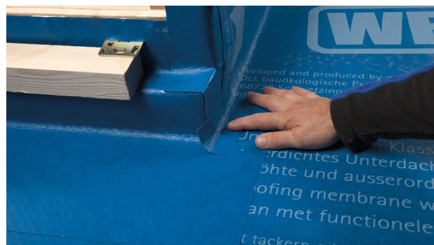
28. Veiller à ce que le chevauchement des écrans permette l'écoulement de l'eau.
