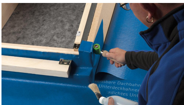
15. Replier les parties qui en dépassent et les souder avec l'écran inférieur. Soigner tout particulièrement l'étanchéité des coins.
