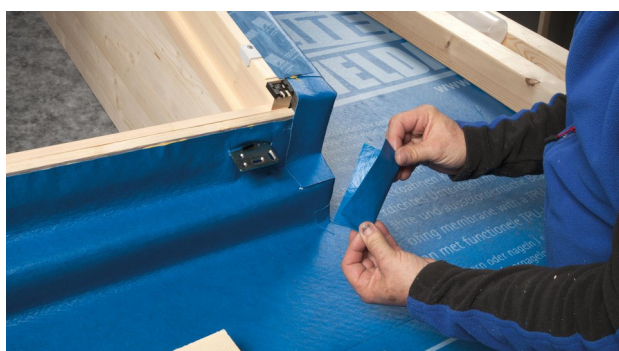
31. Retirer la latte, puis découper des bouts d'écran pour recouvrir les équerres de fixation.
