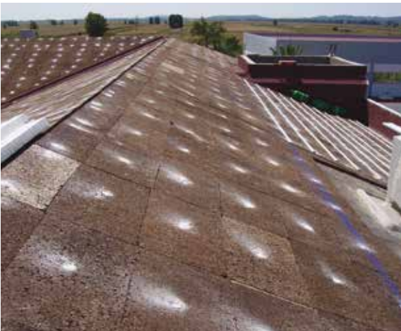
Centre de stages sportifs de Golegã – Golegã, PORTUGAL (Isolation des toitures inclinées)
